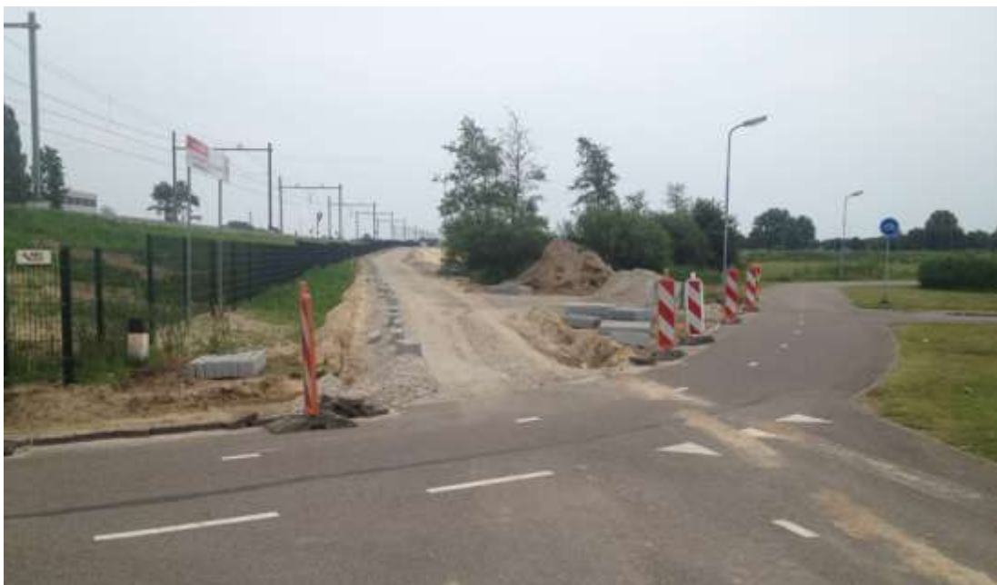
Rysunek 20. Zupełnie nowa część budowanej trasy. Dawne skrzyżowanie dróg rowerowych staje się czteroramiennym skrzyżowaniem dróg rowerowych.
