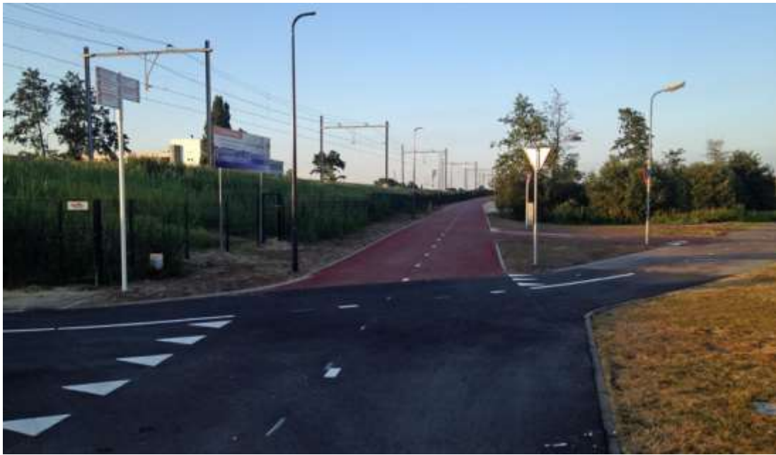
Rysunek 21. Ta sama lokalizacja po zakończeniu nowej infrastruktury i podłączeniu do istniejących ścieżek rowerowych. Priorytet dla osób jeżdżących na rowerze po szybkiej trasie rowerowej.
